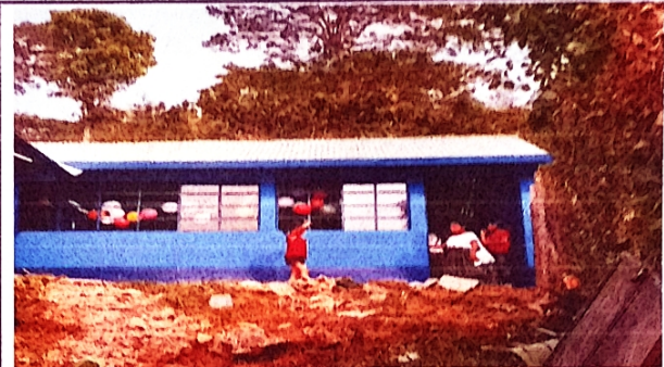
Foto 2: Sustitucion de laminas sobre el aula de cuarto, quinto y sexto primaria.
